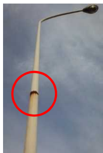
・溶接継ぎ手部の劣化
