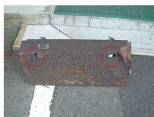
・落下したトンネル照明
