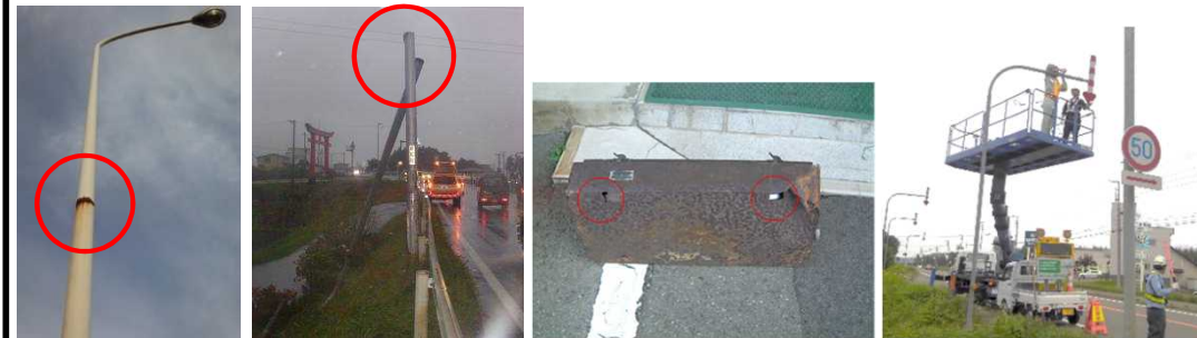
・溶接継ぎ手部の劣化 ・溶接継ぎ手部の破断 ・落下したトンネル照明 ・高所作業車による点検
